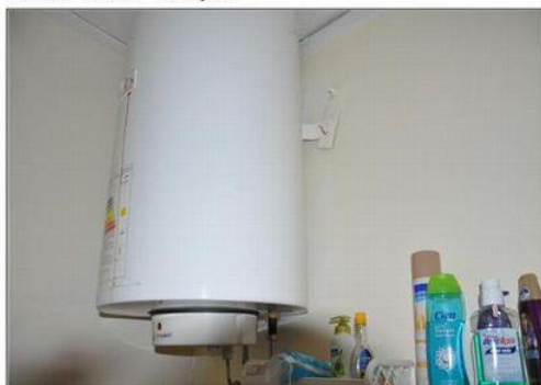
Pohled na elektrický boiler v bytě
